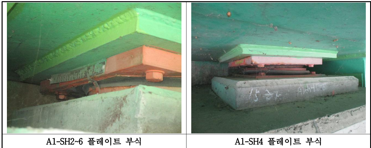
【사진 7.1】 신축이음 누수에 따른 손상 발생 현황
