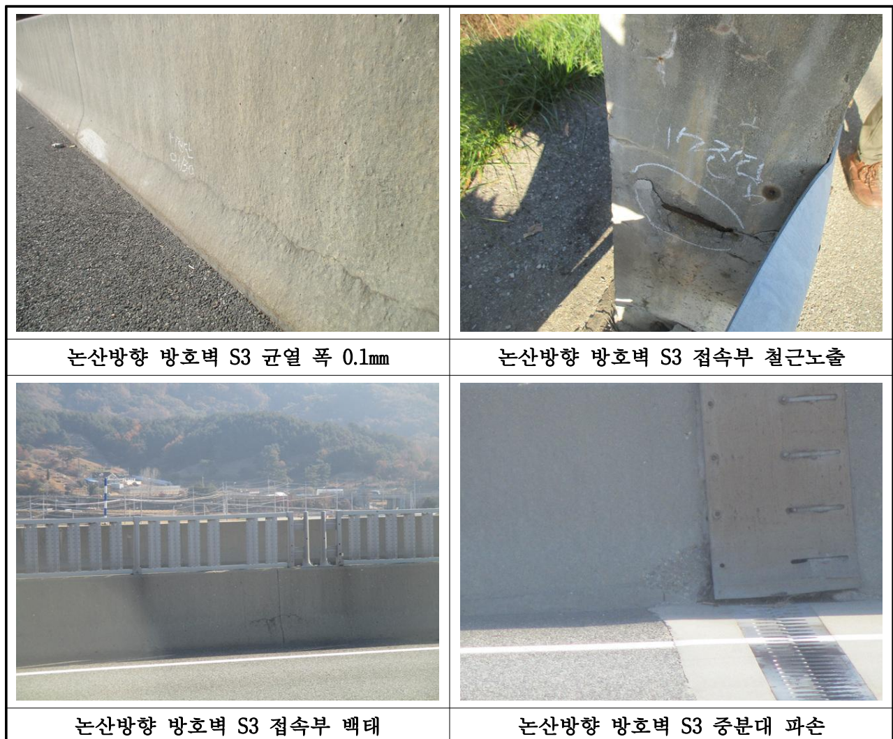
【사진 3.45】 난간 및 연석 손상현황
